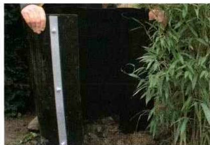
Instalación de un bloqueador de rizomas. El material flexible se adapta a la forma de parterre deseada.
